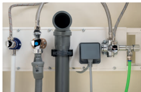
Sauber und übersichtlich montiert: Kalt- und Warmwasser, Abfluss der Spüle, Aufputzsteckdose, Anschluss für Trinkwasserleitung (z. B. für eine Kaffeemaschine mit Festwasseranschluss oder einen Kühlschrank mit Eiswürfelbereiter).
